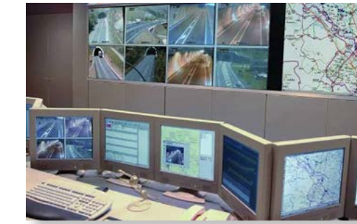
CENTRO DE CONTROL Y VIGILANCIA DE INCIDENCIAS DE SEGURIDAD VIAL PAMPLONA
